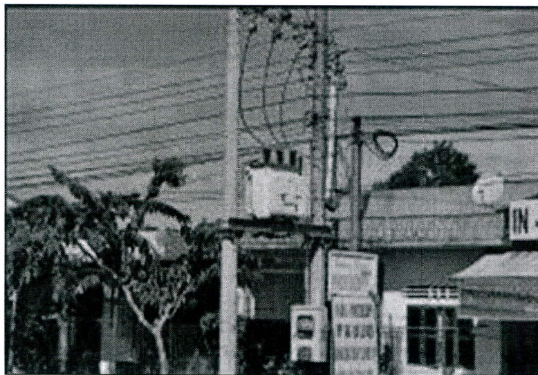
Trạm biến áp phân phối
