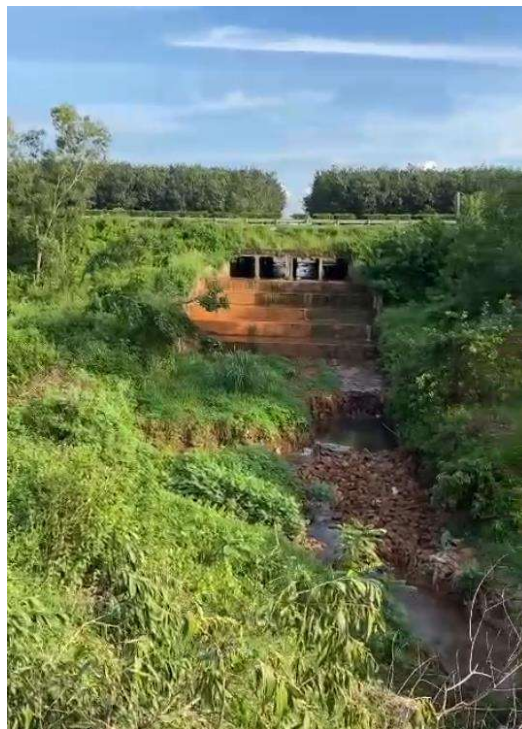
Hiện trạng công hộp hiện hữu 4(2,5x2)m trên đường cao tốc Long Thành – Dầu Giây tại lý trình Km30+120
