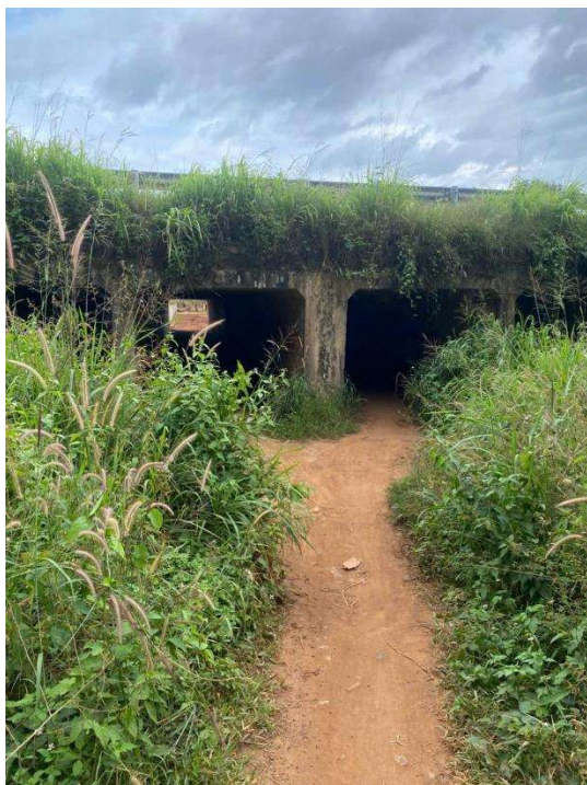
Hiện trạng công hộp hiện hữu 4(2,5x2)m trên đường cao tốc Long Thành – Dầu Giây tại lý trình Km32+980
