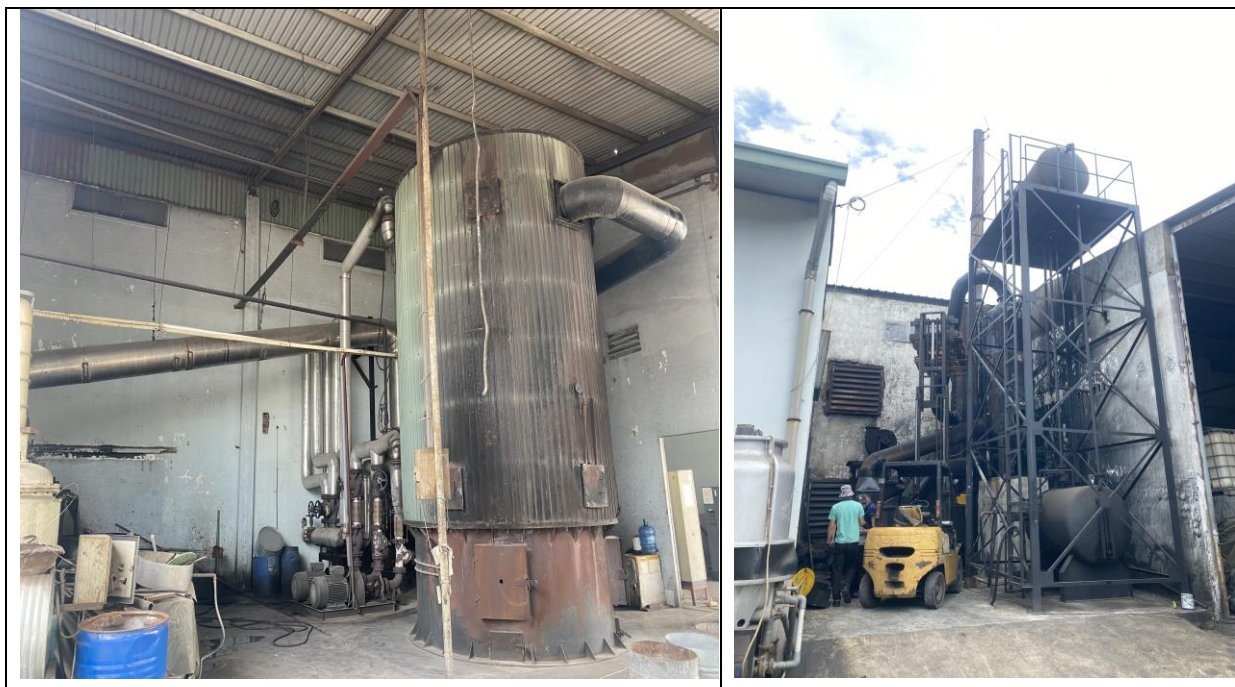
Hình 3.8. Hình ảnh của hệ thống xử lý khí thải lò hơi của cơ sở
