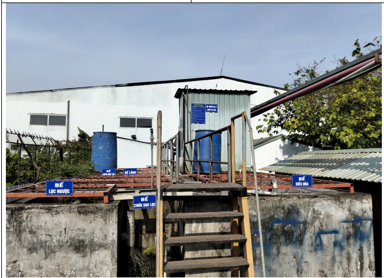
Hình 3.4. Hình ảnh hệ thống xử lý nước thải tập trung 60\text{m}^3/\text{ngày.đêm}
