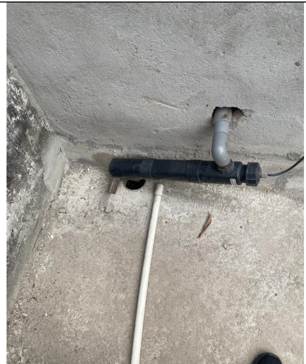
Hình ảnh điểm đầu nối nước thải sau xử lý
