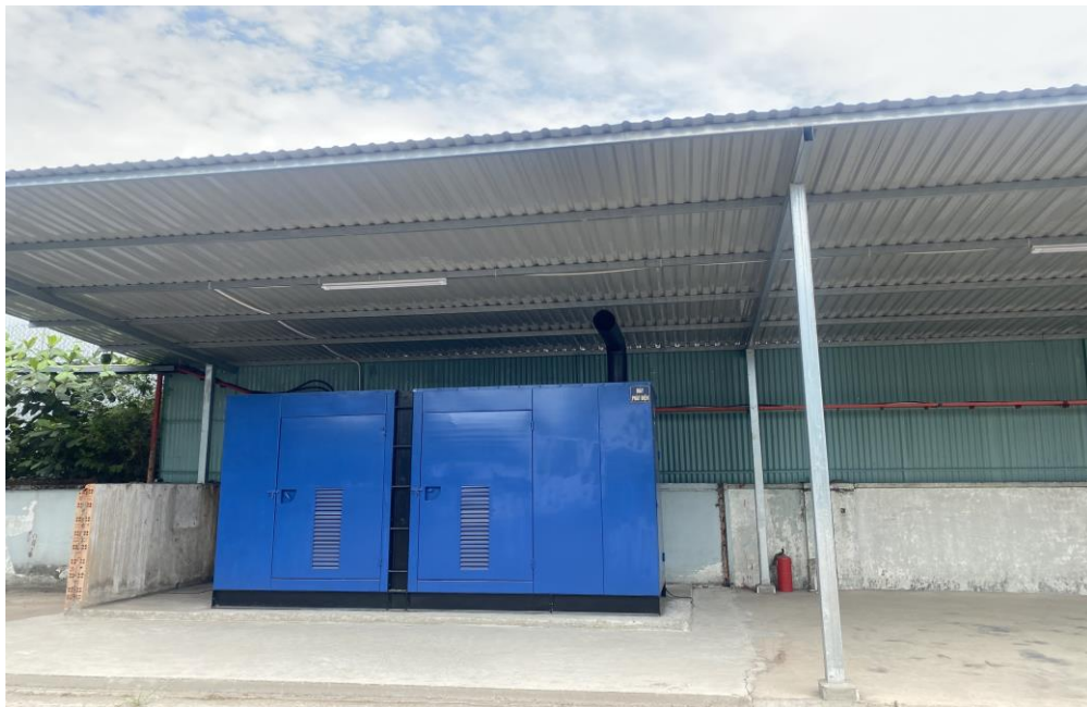
Hình 3.10. Hình ảnh máy phát điện dự phòng của cơ sở
